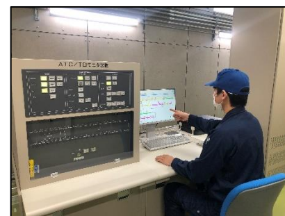
信号保安設備点検
