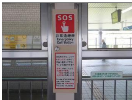
非常通報器（閉じた状態）
