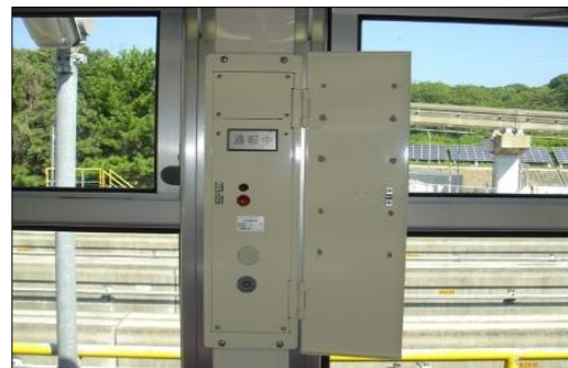
非常通報器（開けた状態）
